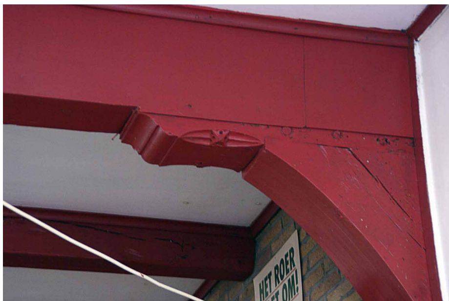
Afb. 18. Het tweede gebint van voren met korbeel en sleutelstuk en daarachter een lichtere trekbalk. Foto auteur, 2008.
